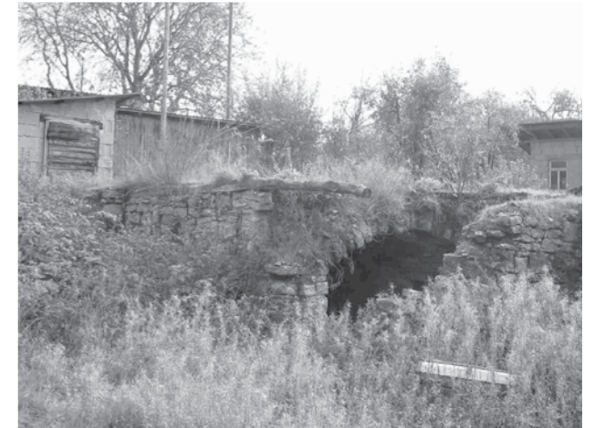
Das Grundstück in Heckfeld mit einsturzfähigem Kellergewölbe
