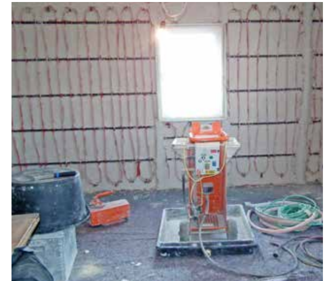
Modernisierung einer Hofanlage in Adersbach: Das Wohnhaus wurde größtenteils in Eigenleistung umfassend energetisch saniert. Die Technik zur Umsetzung einer Innendämmung mit Wandheizung haben sich die neuen Eigentümer in Seminaren angeeignet. Projekt Steuerwald, S. 68-69
