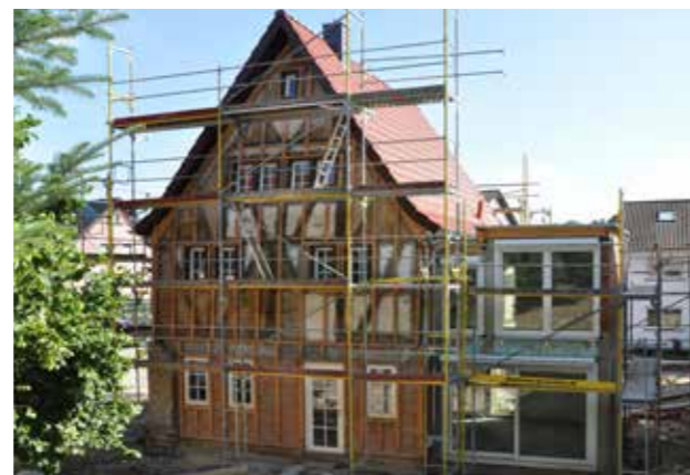
Modernisierung eines Denkmals in Adersbach: Durch den Flachdachanbau wird das denkmalgeschützte Gebäude durch einen großzügigen Wohnraum ergänzt. Gestalterisch hebt sich der Anbau ab, tritt aber neben dem alten Gebäude in den Hintergrund. Projekt Stappenbacher, S.70-71
